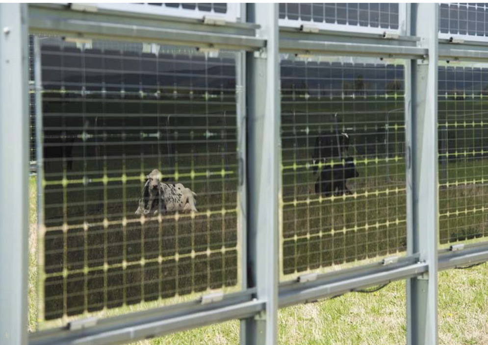
Interesse geweckt: Die Kühe auf der Wiese, auf der die Pilotanlage von Next2Sun steht, zeigen sich neugierig und stupsen immer mal wieder mit ihren Mäulern gegen die Module.
