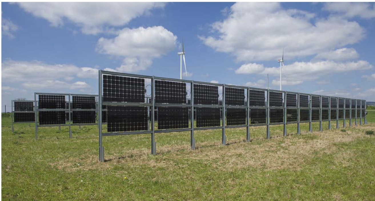
Die Modulreihen stehen mit zehn Metern Abstand zueinander, um Verschattungen zu minimieren. Aus demselben Grund müssen auch die Module selbst seitlich etwas Abstand zum Montagesystem halten.
